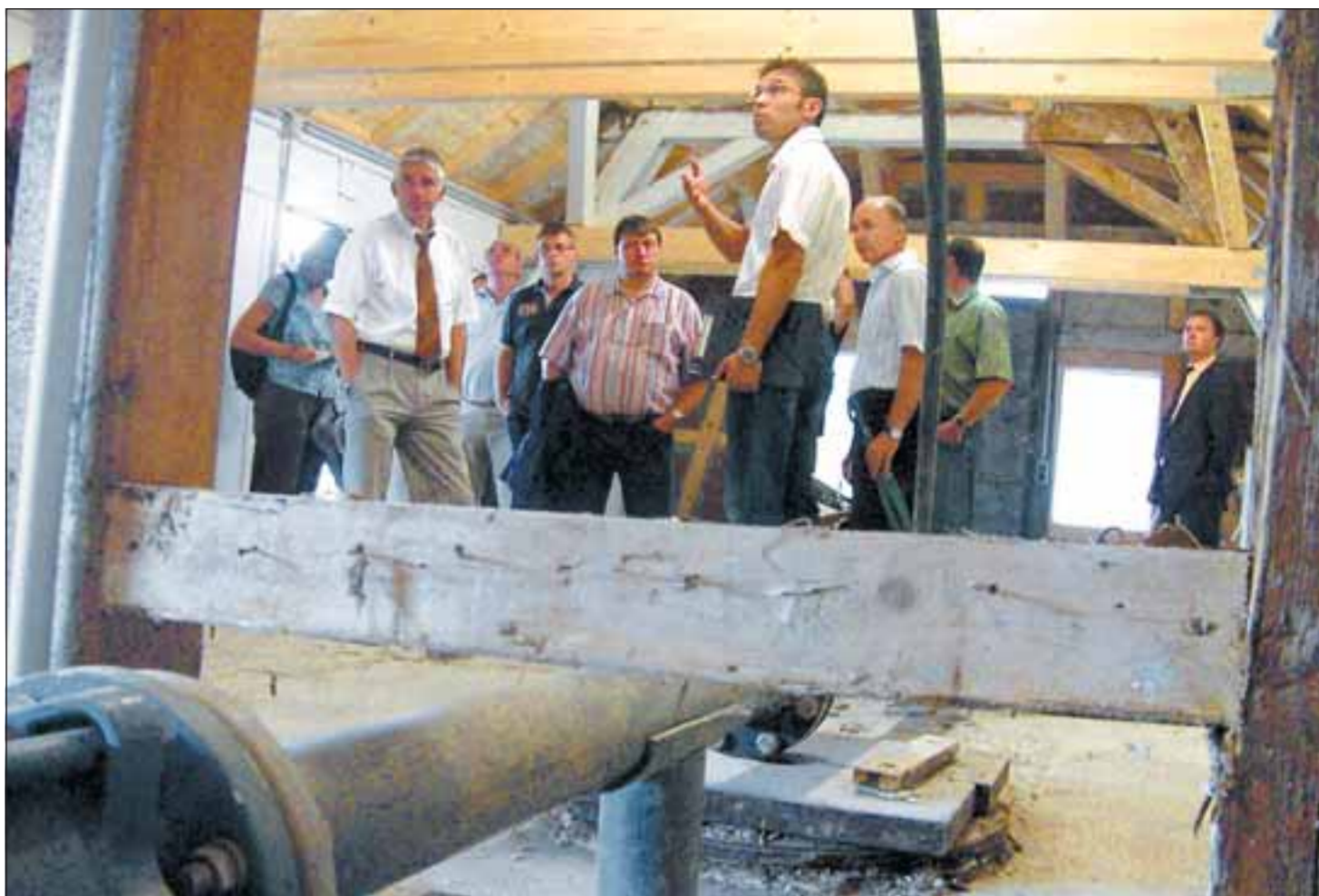
Umfassend in Stand gesetzt wurden zwei der fünf Bohrhäuser am Einsiedelwald. Im Vordergrund entspringt die Leitung dem Solereservoir und versorgt so unter anderem die Kurbetriebe mit in Wasser gelöstem Salz. Foto: Beck
