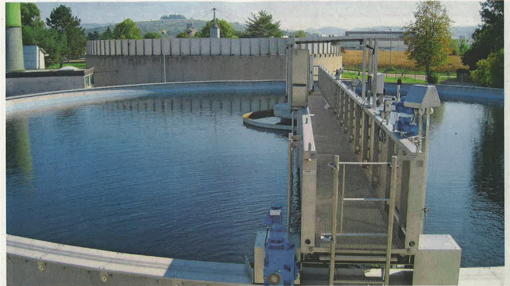
Das Sedimentationsbecken ist ein Bestandteil der neuen Reinigungsstufe im Klärwerk des Abwasserverbands Raumschaft Lahr. FOTO: ABWASSERVERBAND RAUMSCHAFT LAHR
