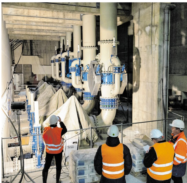
Pumpschnecken mit einer mächtigen Leistung: Acht Kubikmeter Abwasser kann die Anlage pro Sekunde hinauf ins Klärwerk fördern.
