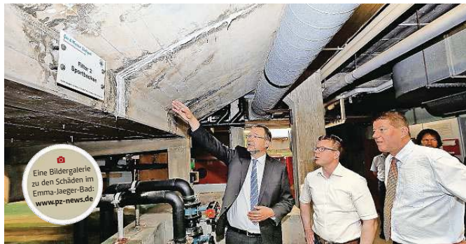
Ausbühlungen, Abplatzungen, Lochfraß: Sorgenvoll blicken OB Gert Hager, Experte Markus Hofmann und der Erste Bürgermeister Roger Heidt (von links) in den „Emma“-Katakomben auf die Unterseite des Nichtschwimmerbeckens.
