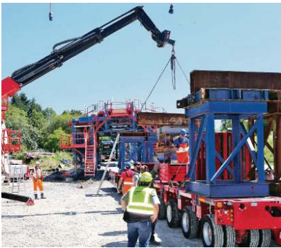
Die baulichen Vorbereitungen für den Innenausbau des neuen Bahntunnels der Stammstrecke zwischen Ispringen und Pforzheim sind in eine entscheidende Phase gekommen. In der Nacht auf heute sind mit speziellen Tiefladern die ersten beiden Komponenten (unten) des „Schalzugs“, die auf dem künftigen Rettungsplatz auf Ispringer Seite zusammengebaut wurden, zum Tunnelmund gefahren worden. Zwei weitere Teile, darunter der eigentliche Schalwagen (Bild oben), folgen in der Nacht zum Mittwoch. Dafür muss die Landesstraße von 23.45 bis 4.30 Uhr erneut voll gesperrt werden. Die restlichen Teile folgen in einigen Wochen. gk
