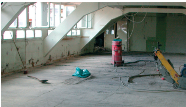
Abgefräster schwermetallhaltiger Industrieestrich
