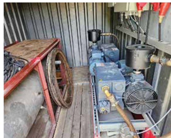
Blick in den Überwachungscontainer
