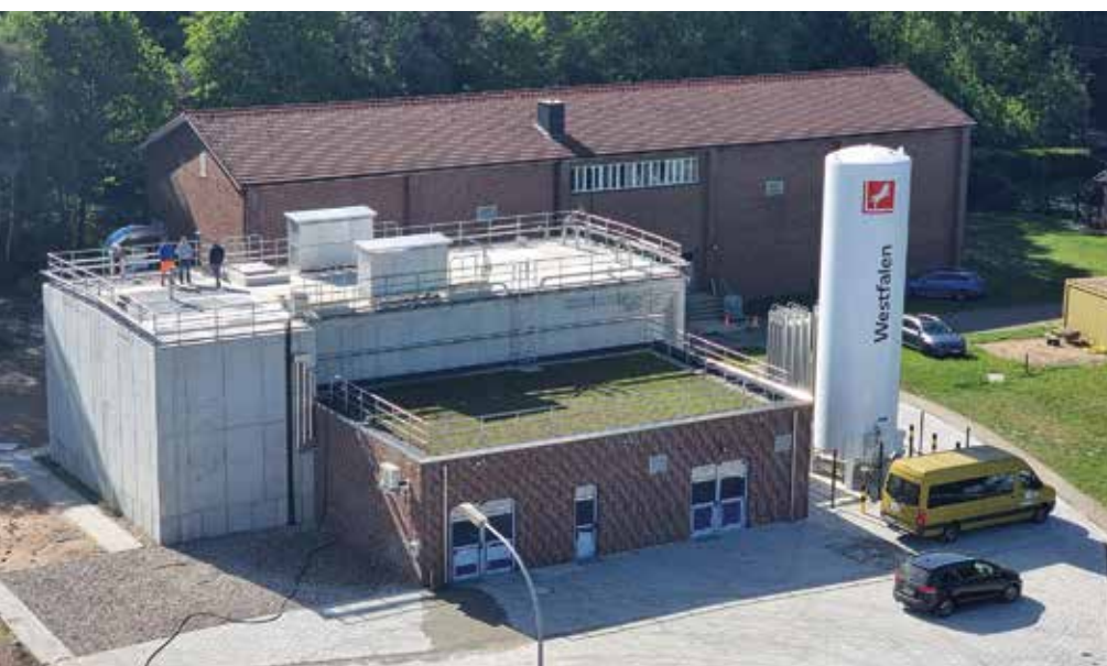
Fertige Anlage (im Vordergrund Ozonung, im Hintergrund Sandfilter)
