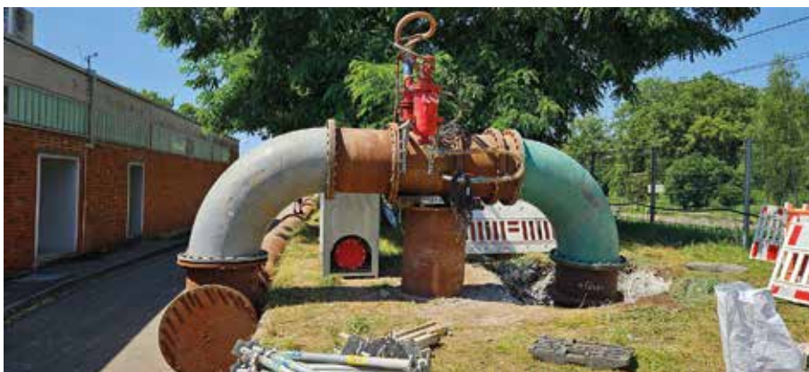
Heberleitung DN 800 – Hochpunkt an Einleitstelle
