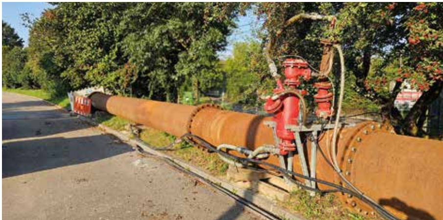
Heberleitung – Hochpunkt nach Düker
