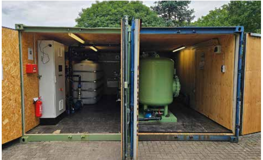
Blick in die Grundwasseraufbereitungsanlage
