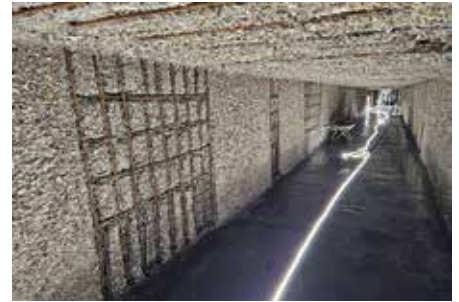
Flächen mit frei gelegter Bewehrung und Reinigung
